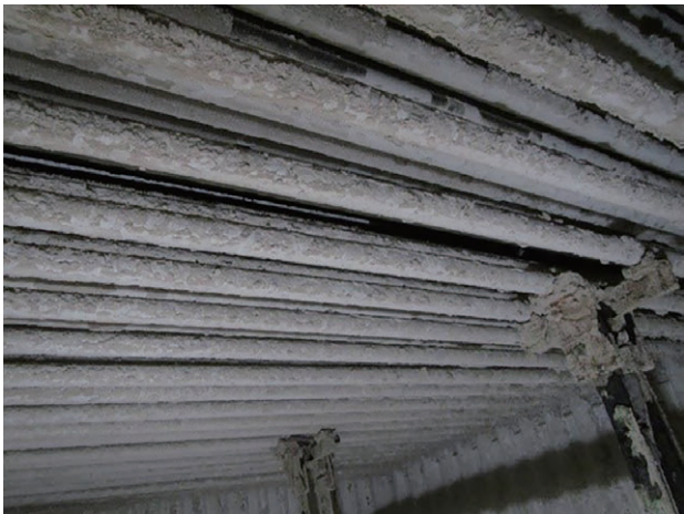
装置導入後 過熱器 (200日間運転後)
