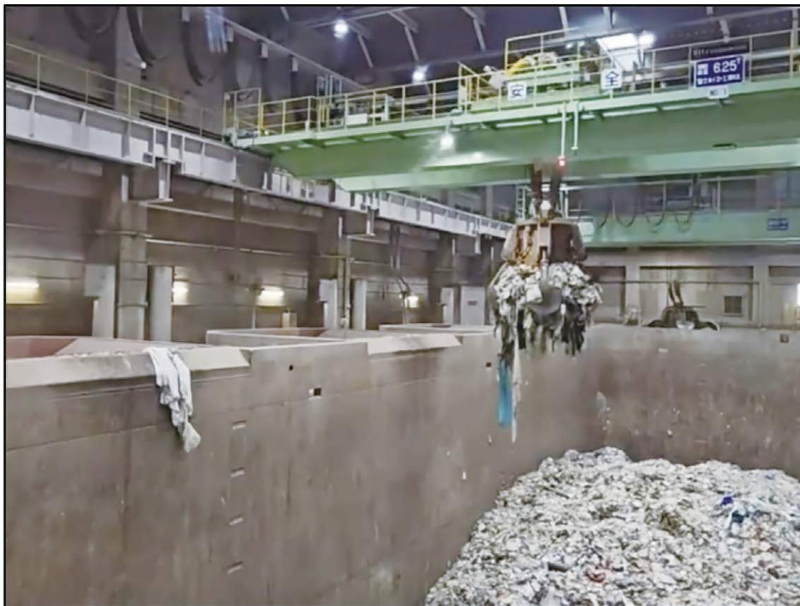
写真1 ごみ焼却発電施設のごみクレーン
