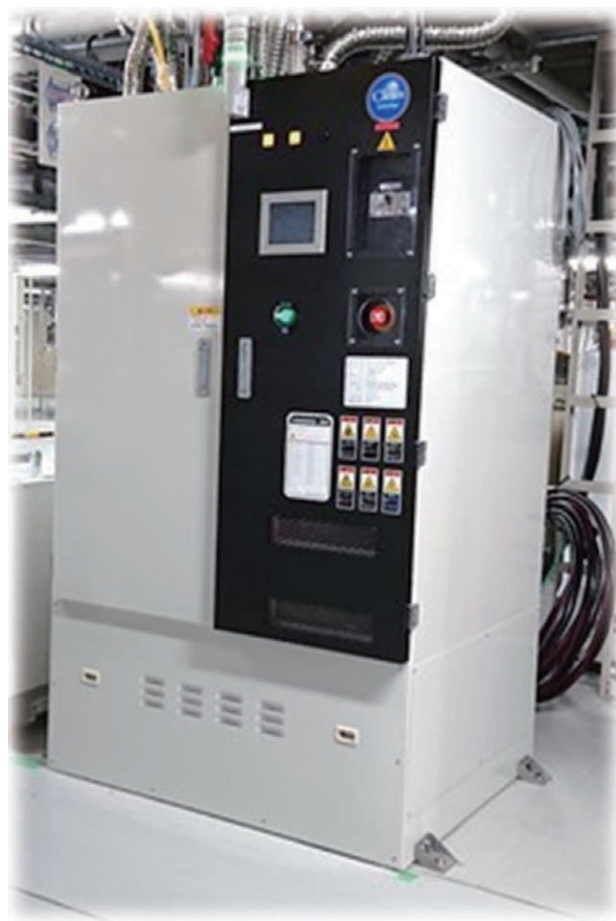
写真1 国内最新半導体工場稼働中の装置
