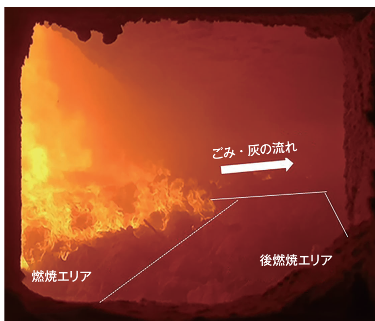
図6 炉内燃焼状況
